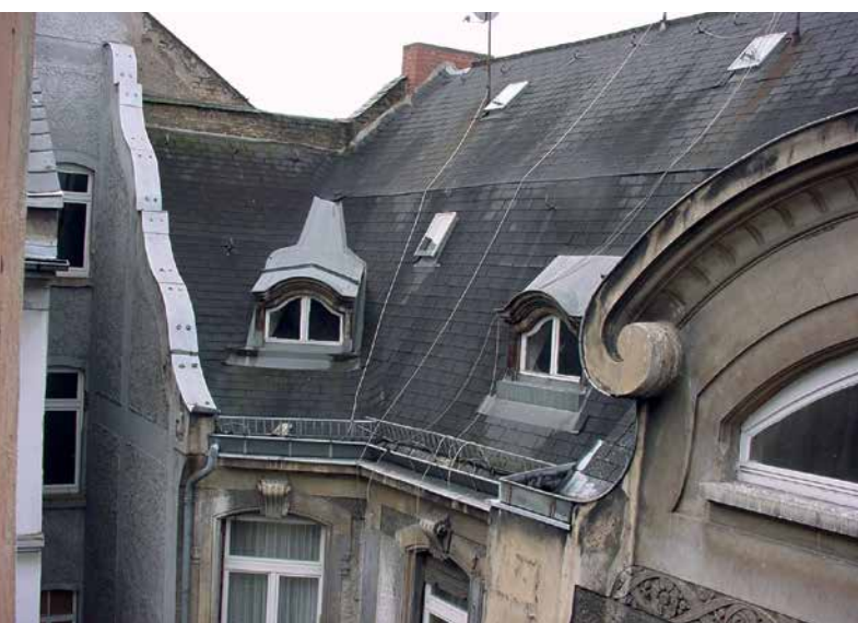
Abb. 23 Kleine Schwalbacher Straße – Eine aufwendige Gestaltung des Dachanschlusses macht eine Aufsparrendämmung bisweilen unmöglich.
