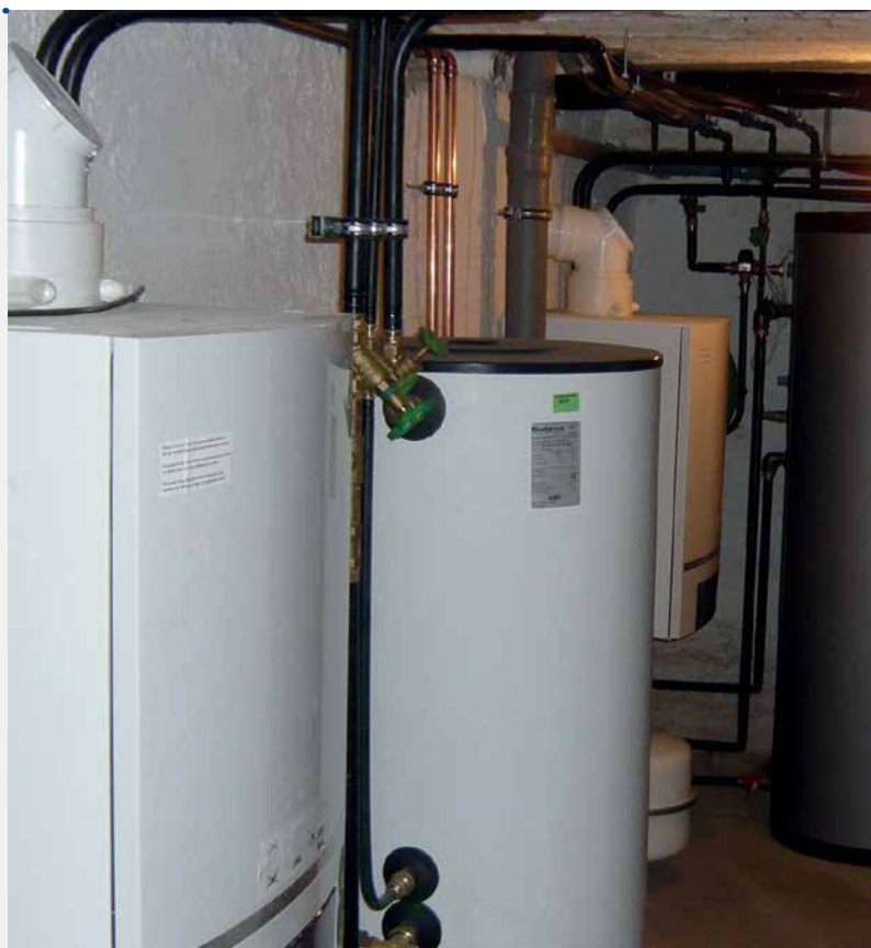
Abb. 67 Adlerstraße – Heizungsanlage mit Gas-Brennwertkessel und solarthermischem Pufferspeicher
